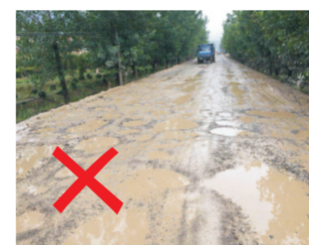
坑洼、颠簸路面
